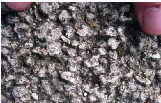
写真② 有機系バインダー使用の透水性コンクリート (施工後5年以上経過)
